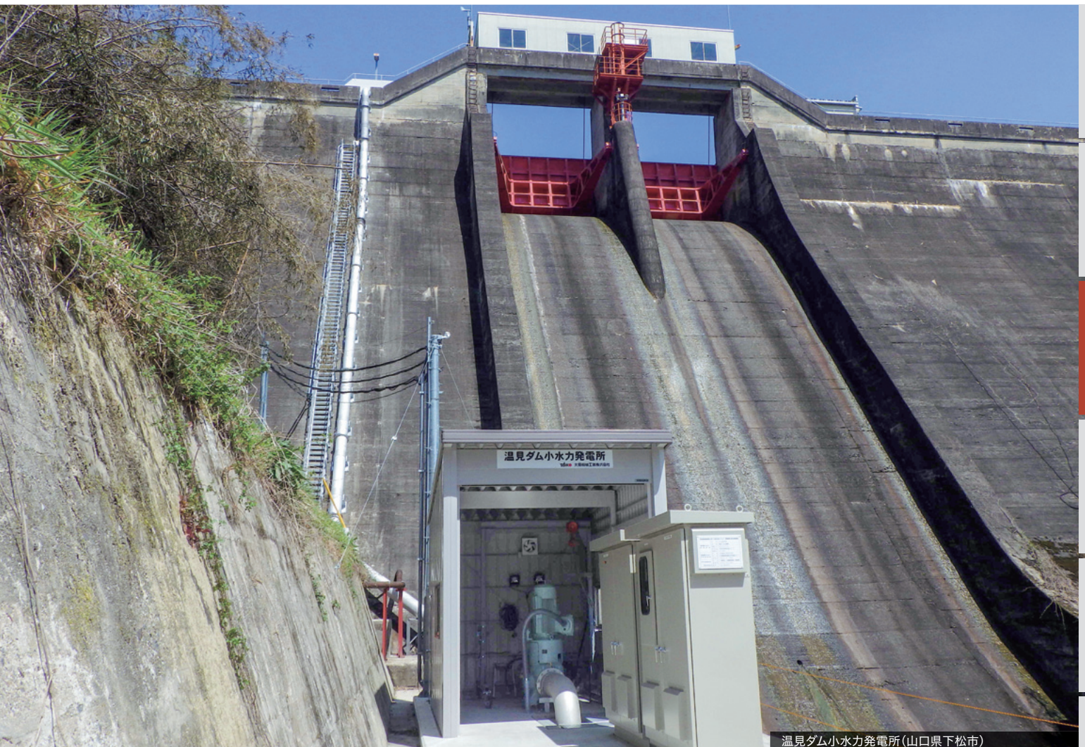
温見ダム小水力発電所 (山口県下松市)
